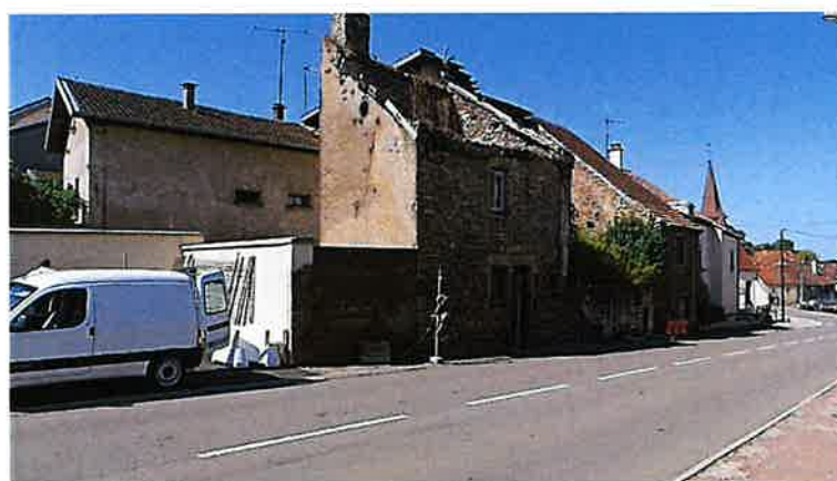
Vue prise lors de la mise en sécurité en août 2013
